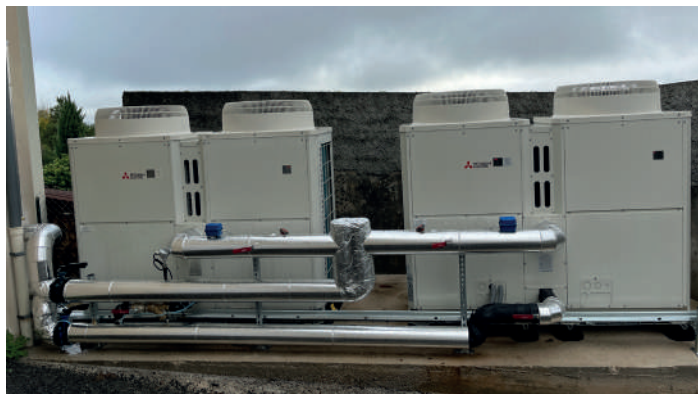
Pompe à chaleur du groupe scolaire
