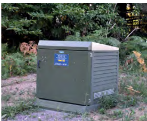
Transformateur du Moulin Bas
